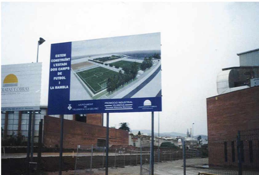
Construcción de campos de fútbol en Vilanova i Geltrú (Barcelona), dónde se instaló el sistema (Foto: Ecoagua)
