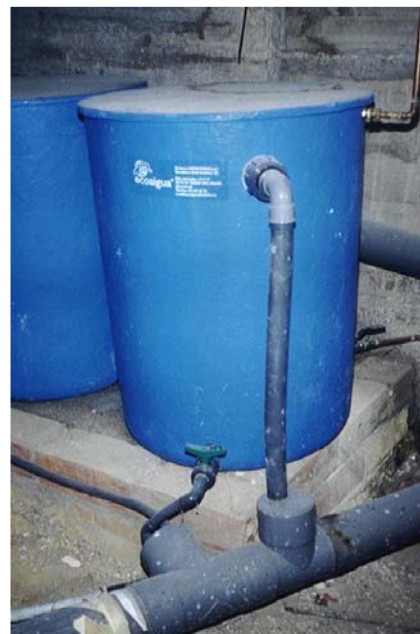
Depósito instalado en el sótano (Foto: Ecoaigua)
