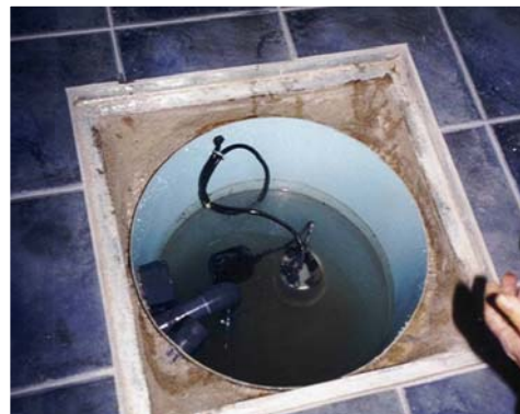
Interior del deposito arqueta donde va instalada la bomba (Foto: Ecoaigua)
