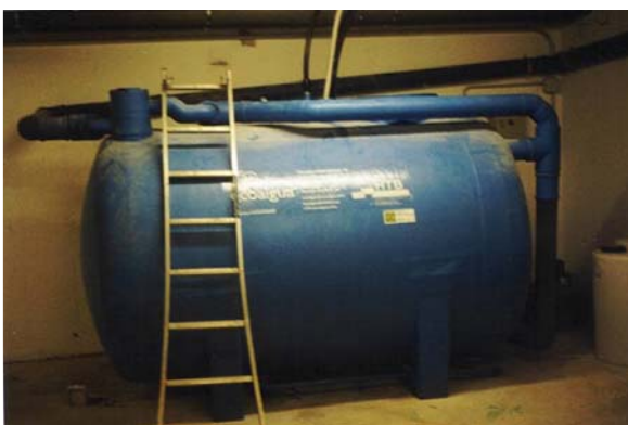
Depósito que, a su vez, envía el agua a un aljibe (Foto: Ecoagua)
