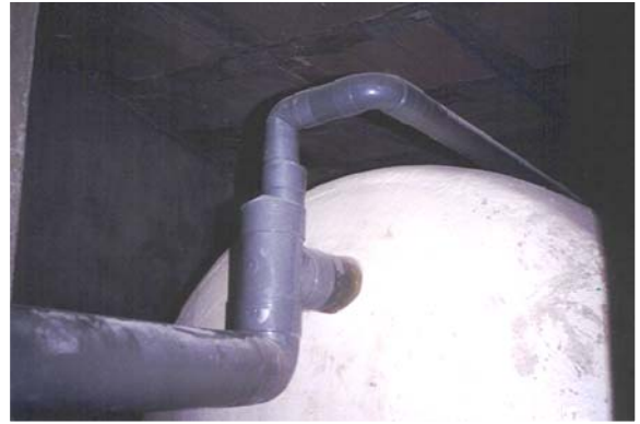
Depósito depuradora instalado en los sótanos del hotel (Foto: Ecoagua)
