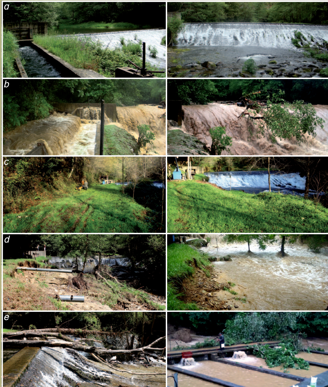
Figura 10.1: Debido a las lluvias de junio de 2010 se produjo una crecida extraordinaria del río Turia que originó importantes daños en una instalación acuícola. La fuerza del agua, junto con la llegada de troncos, ramas, piedras y demás materiales, dañó la presa, el azud de entrada y el canal de la instalación, arrastrando unos 12 m de longitud del camino de acceso desde la instalación a la presa y unos 4 m de ancho del camino con servidumbre de paso que rodea a la instalación. El agua se introdujo debajo de parte de los estanques y los descalzó. Además, se produjo una entrada de lodos en los tanques, que ocasionó una pequeña mortandad de peces. El gasto en la limpieza de las instalaciones fue elevado. Durante el tiempo que duró la riada se tomaron todas las precauciones necesarias para proteger a los peces y se siguieron las indicaciones para conseguir las pruebas sobre el origen y el resultado de los daños. (a y b) Vista de la toma y el azud de la instalación acuícola antes y después de la crecida. (c y d) Conducción a la instalación. Zona en que desapareció el camino y el muro de mampostería 2,0 m. (e) Daños en los estanques
