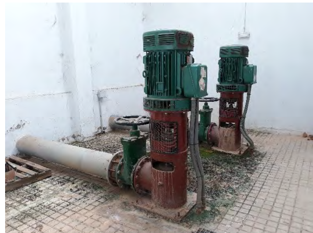
Bombas de elevación en el río Ebro.
