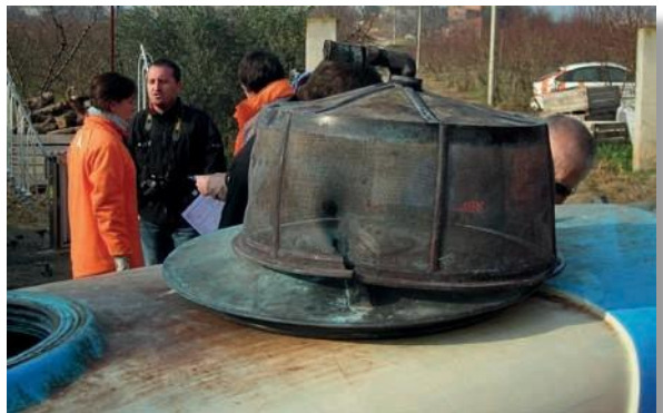
Filtro de llenado en condiciones no aceptables
