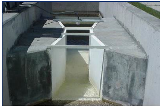
Canal (o aforador) Parshall con medidor de nivel
