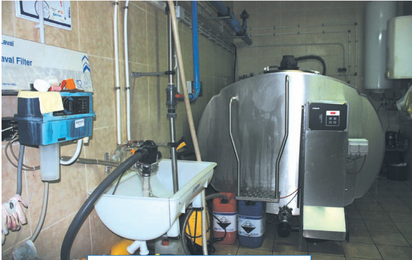
TANQUE DE ENFRIAMIENTO Y SISTEMA DE LAVADO DEL MISMO
