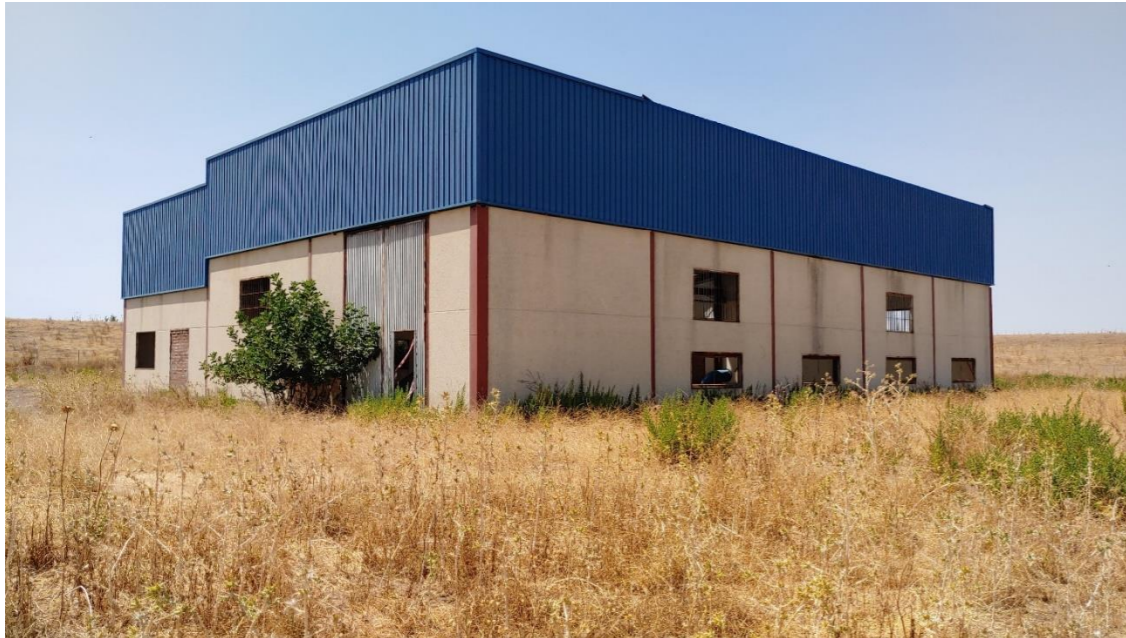
Imagen 2. Vista general del estado actual de la estación de bombeo para riego EB-2 (1).
