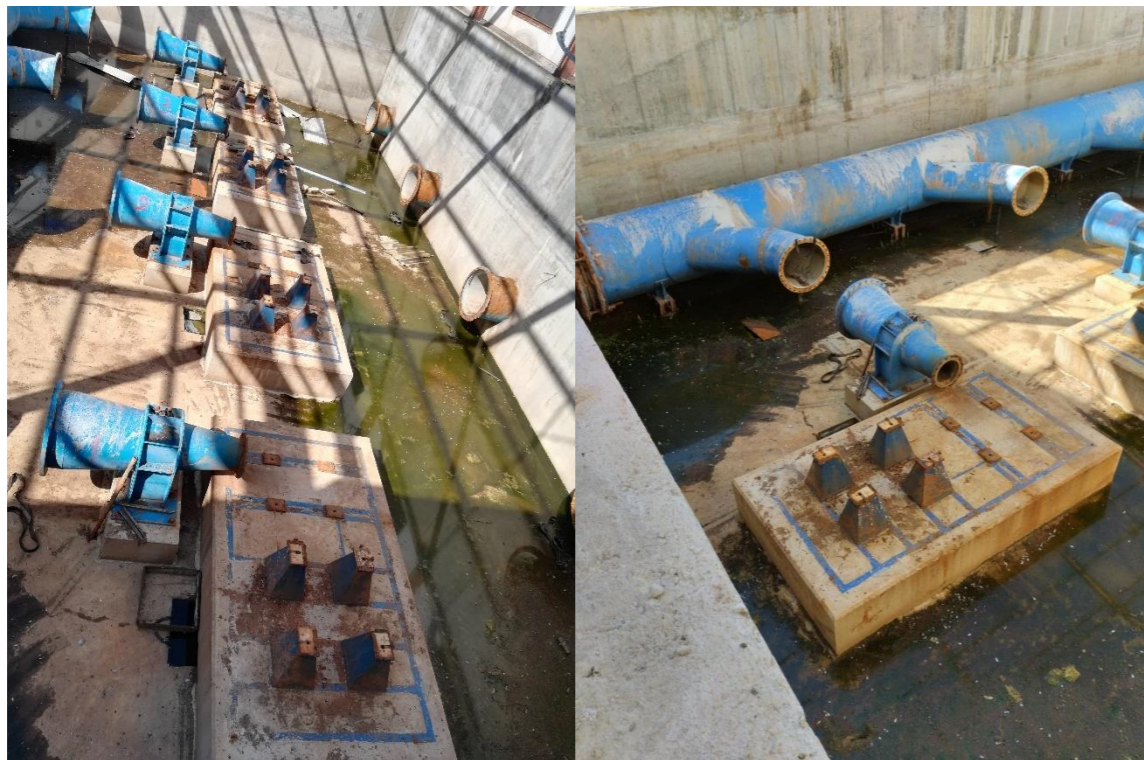
Imagen 15. Bancadas de apoyo y conos de ampliación anclados. Estación de bombeo principal.
