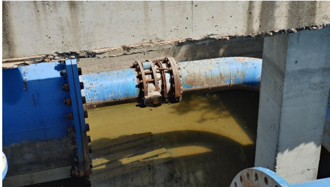
Imagen 22. Válvula de mariposa y carrete en by-pass. Estación de filtrado.
