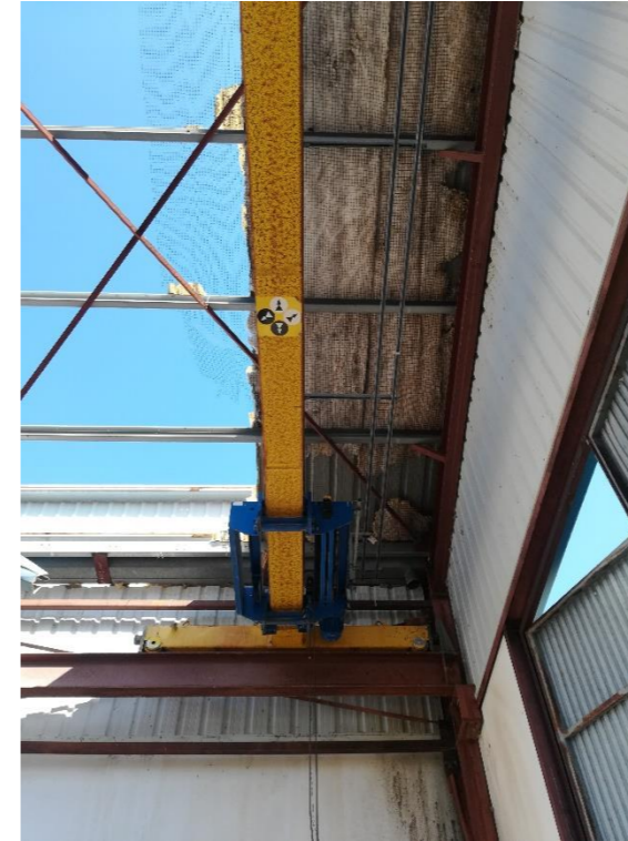
Imagen 18. Estado actual puente grúa. Estación de bombeo principal (1).
