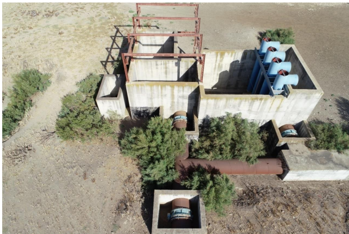
Figura 4. Vista general del estado actual de la estación de bombeo de llenado de las balsas (4)
