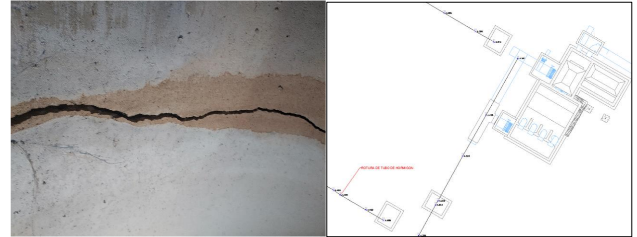
Figura 8. Vista del colector de hormigón armado roto en colector de conexión entre balsas
