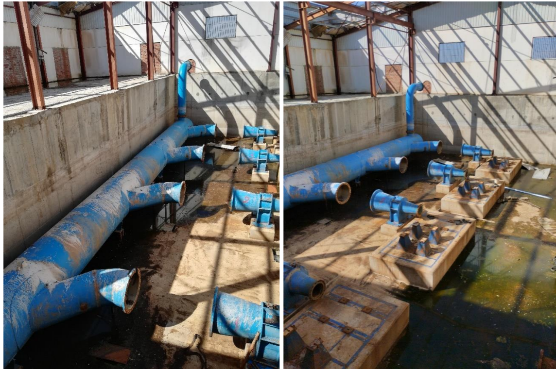
Imagen 14. Colector de impulsión general y piezas de calderería. Estación de bombeo principal.
