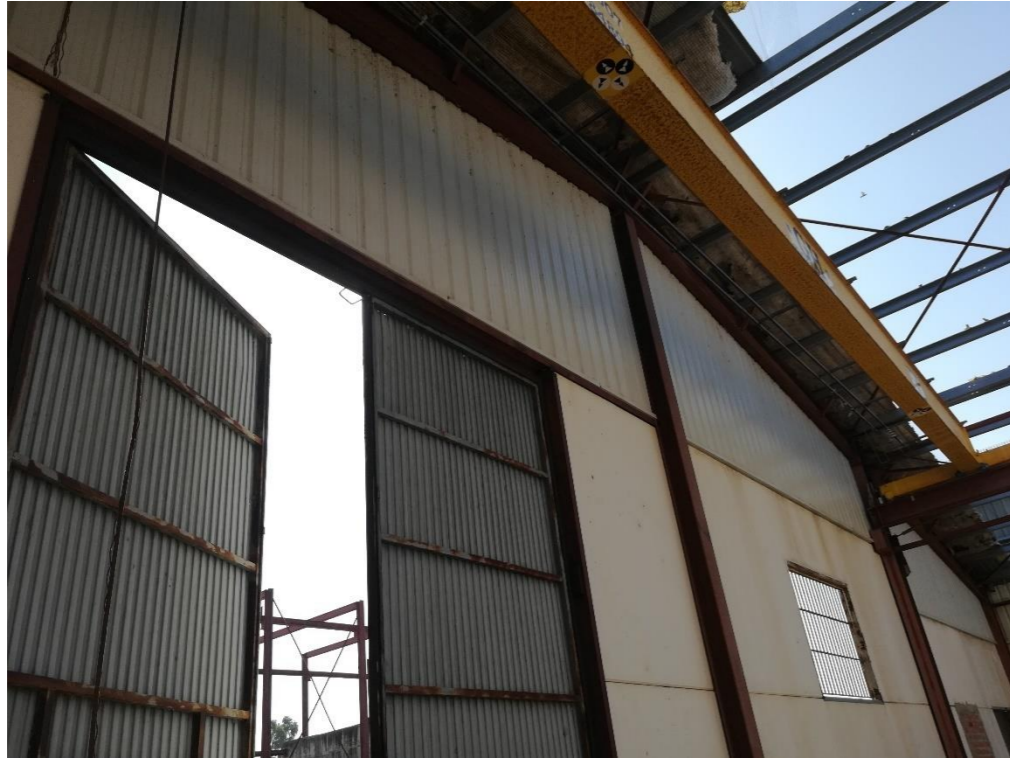
Imagen 16. Vista interior de puerta principal y puente grúa.
