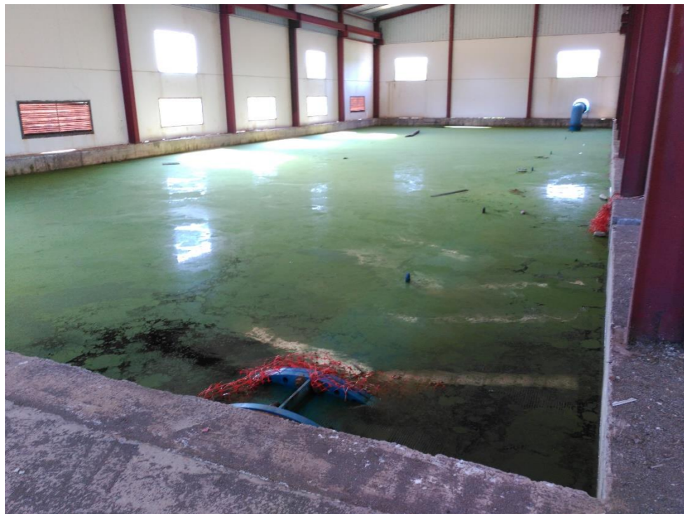
Fotografía 4: Fotos el foso de bombeo para alojamiento de bombas de impulsión a red de riego inundadas.
