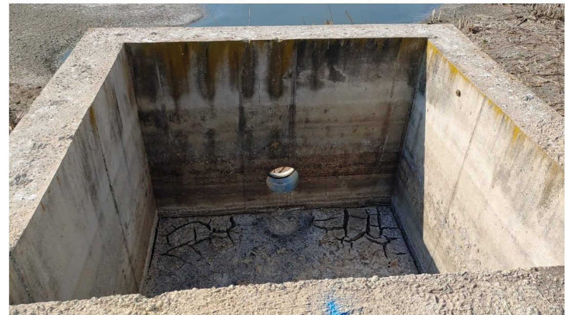
Figura 21. Estado actual de la obra de toma de la aspiración desde la Balsa de Regulación (1)
