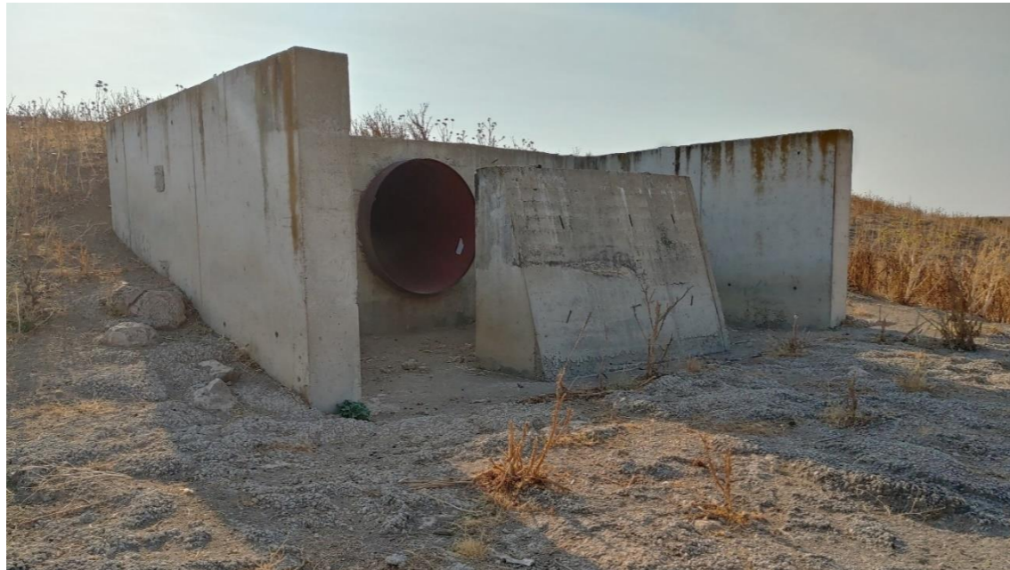
Figura 19. Estado actual de la obra de descarga a la Balsa de Regulación (3)
