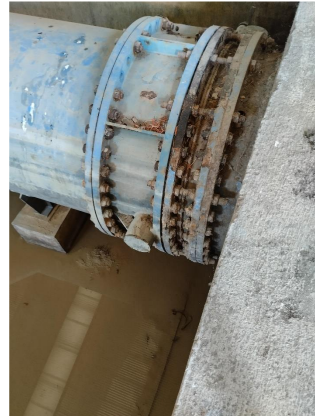
Fotografía 9: Válvula de corte principal del colector de impulsión.
