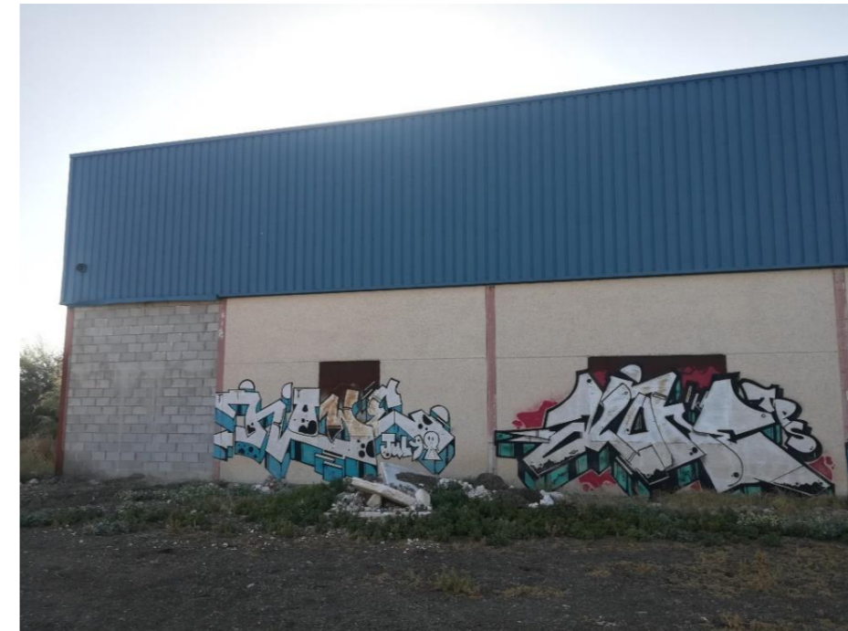
Fotografía 2: Vista exterior del estado de la fachada norte del edificio. Se observa el cerramiento de uno de los paños mediante bloques de hormigón prefabricados en lugar de los paneles prefabricados originales.
