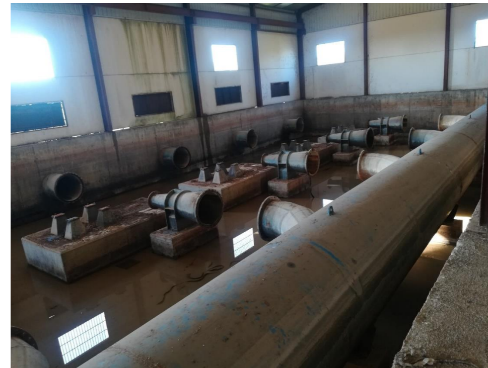
Fotografía 5: Fotos el foso de bombeo en su estado actual, con los equipos electromecánicos de la cadena de grupo de cada bomba desmontada (bombas, motores y valvulería) para su inspección y adecuación por taller especializado.
