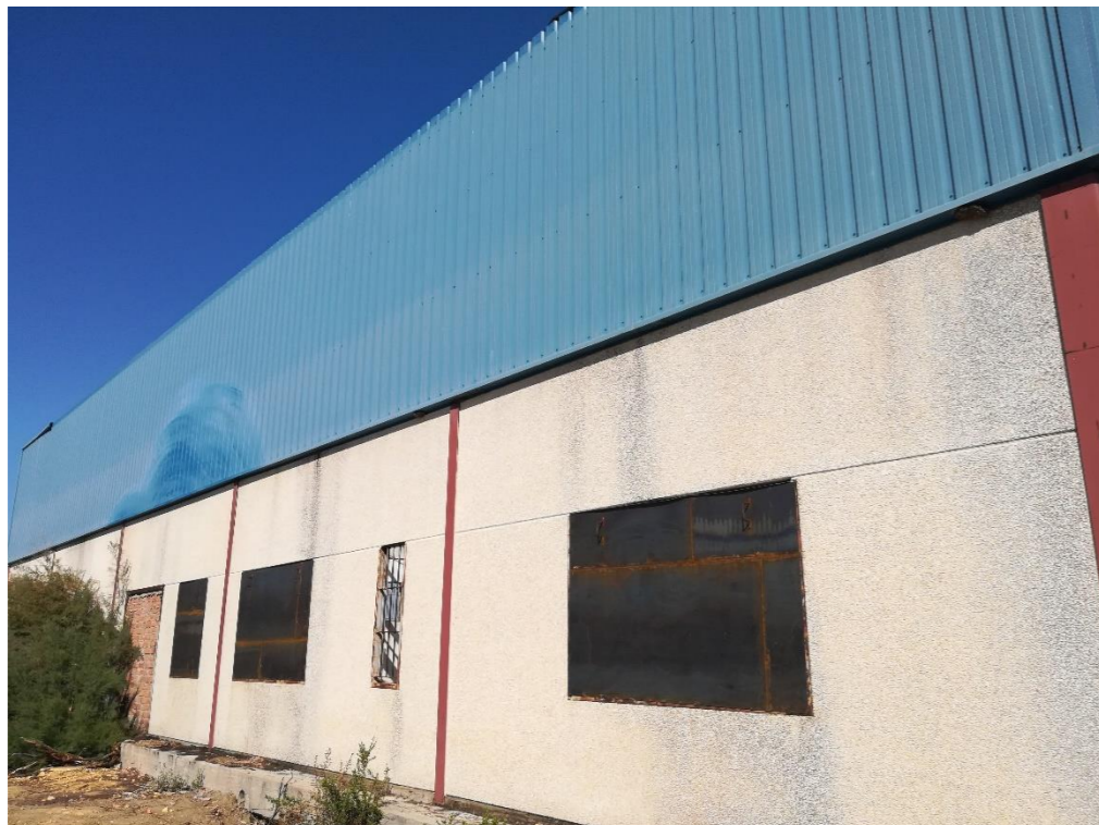
Imagen 5. Rejas, tapiado de ventanas y puertas de acceso. Alzado este de la estación de bombeo principal.
