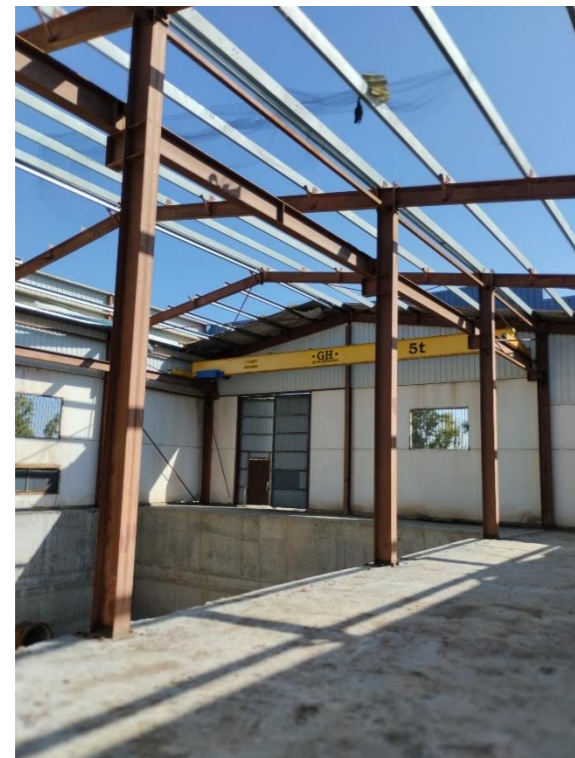
Imagen 17. Vista general y detalle del puente grúa. Estación de bombeo principal.
