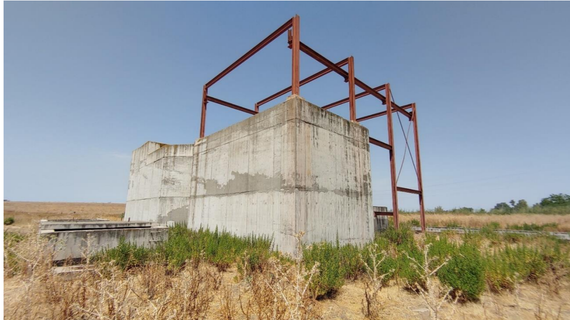
Figura 10. Estado actual de la estación de bombeo (EB) de llenado de las balsas (1)
