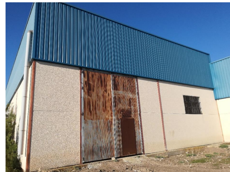
Fotografía 3: Acceso al edificio de bombeo en el lateral de ubicación del foso de bombas
