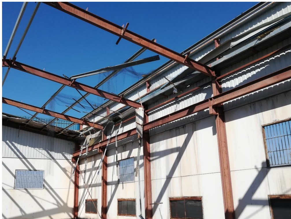
Imagen 9. Daños en correas de la cubierta metálica. Estación de bombeo principal (1).
