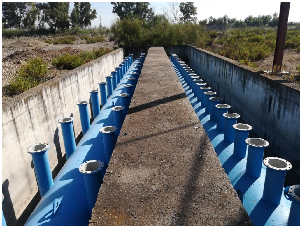
Imagen 20. Vista general de la estación de filtrado.
