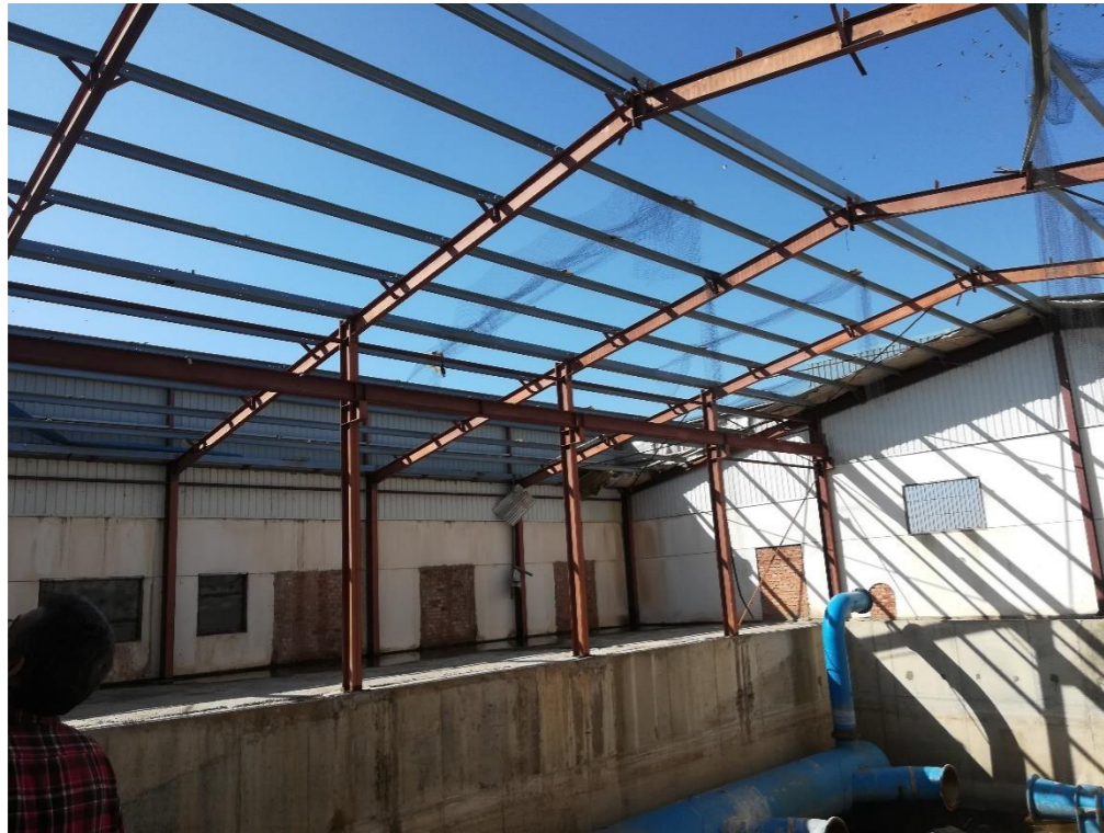
Imagen 8. Estructura metálica y cubierta. Vista interior de la estación de bombeo principal.
