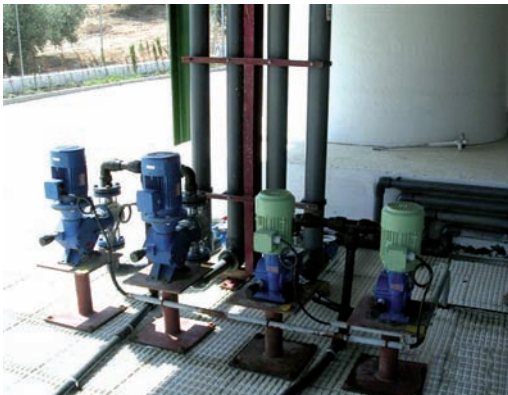
Instalación de fertirrigación: bombas dosificadoras eléctricas
