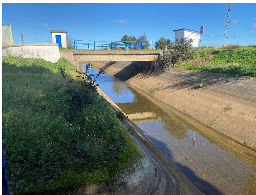
Figura 25. Afección Canal de Lobon sector A
