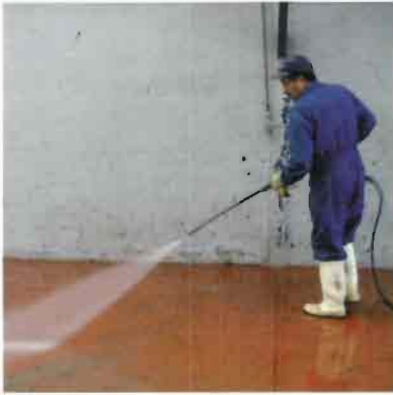
Fig. 21.- Limpieza de un Clyd.
