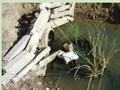
5. Daños en infraestructuras
