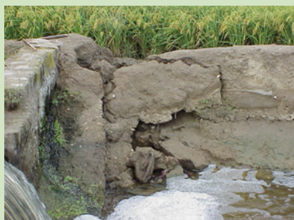
2. Daños en márgenes
