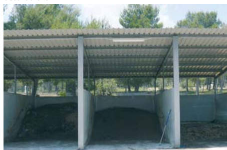
Figura 3. Almacenamiento de deyecciones sólidas en estercolero.
